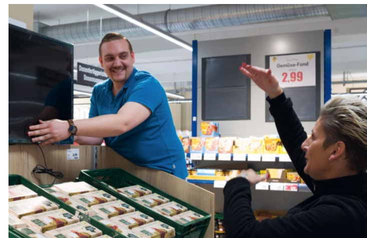
Insgesamt installierten Marco Kruse und sein Team 17 TV-Screens in den EDEKA Kruse-Märkten in Ostfriesland.
